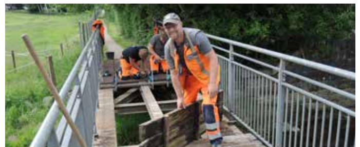
Andre Brodersen (Vordergrund) transportiert die alten Bohlen weg, hinten belegen Lars Kiesbye-Evers und Clemens Tratz die Brücke neu.
